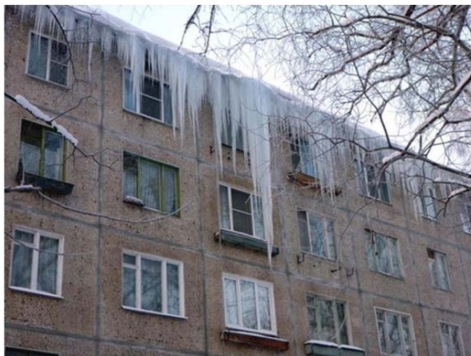
Рисунок 4 - Образование наледей и сосулек на свесах карнизов жилого дома с бесчердачным типом покрытия
