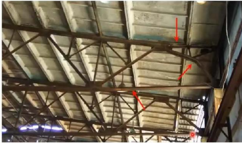
Рисунок 2 - Искривление опорного раскоса стропильной фермы
