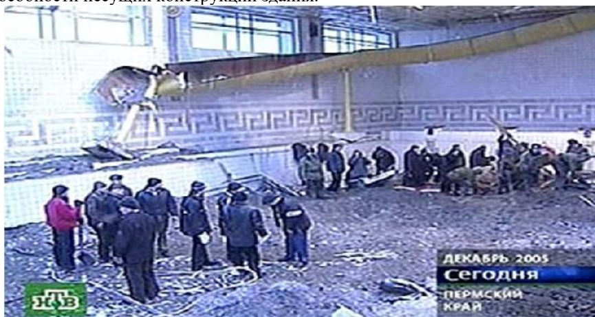
Рисунок 5 - Обрушение крыши бассейна «Дельфин» в г. Чусовой Пермского края
