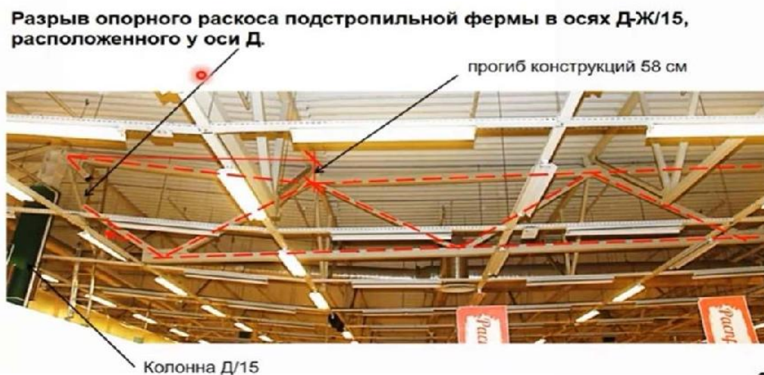
Рисунок 1 - Разрыв опорного раскоса в стальной стропильной ферме
