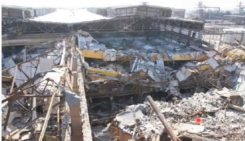
Рисунок 3 - Обрушение покрытия цеха
