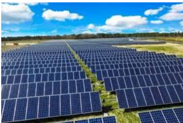
Рис. 1. Первая в Армении промышленная солнечная электростанция "Масрик-1"
