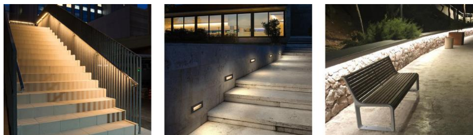
Рис. 25. Примеры устройства освещения, не препятствующего движению посетителей (слева направо – прибор освещения встроен в ограждение; встраиваемые в стену приборы для освещения ступеней; линейный светильник для освещения подпорных стенок)
